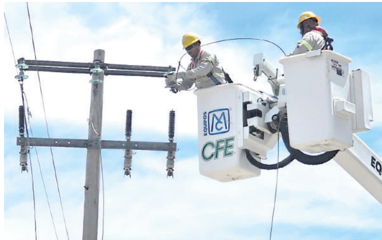
La CFE fortalece la infraestructura y el mantenimiento preventivo. Bajó 72% el tiempo de restablecimiento.
